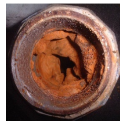
劣化した給水管の例
