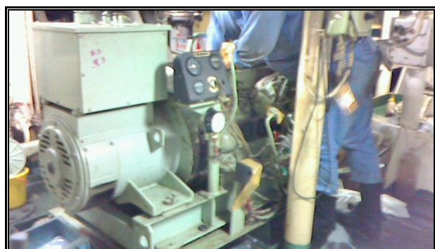
(停泊用発電機の例…船尾操舵室内に設置)
