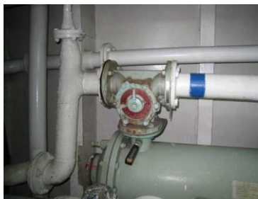
← 主機冷却水(清水)の温度調整弁
