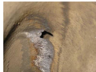
●排気ガス側の腐食②
