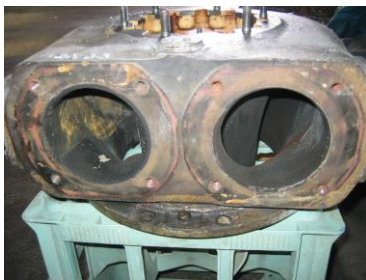
●過給機の排気ガス入口ケーシング (左側内部に損害が発生)
