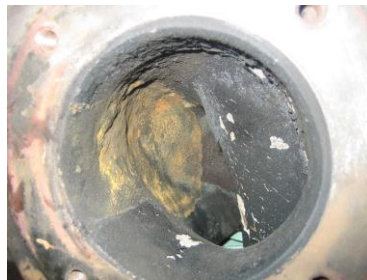
●排気ガス側の腐食①
